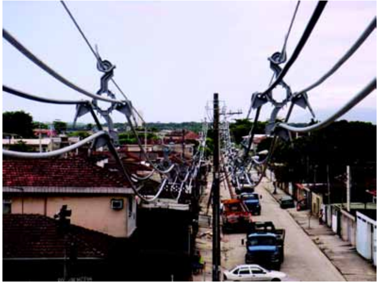
Rede Compacta da CPFL com Espaçadores PLP com Garras
