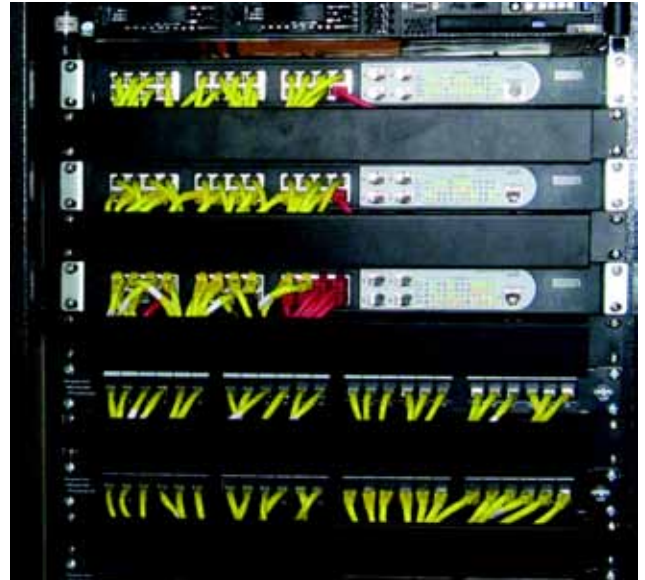
Rack instalado com cabeamento PLP.
