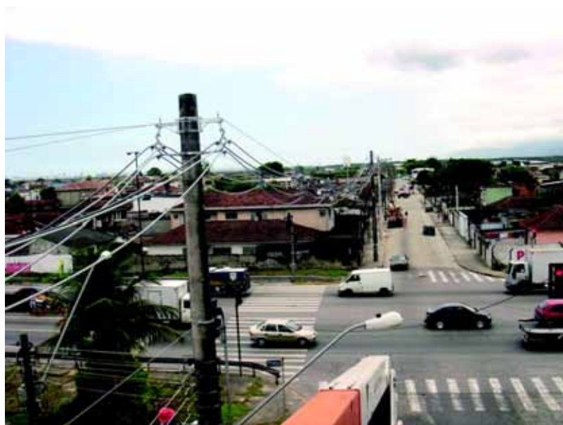
Rede Compacta da CPFL sobre a Rodovia dos Imigrantes
