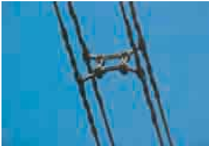
Espaçador Amortecedor PLP instalado há 23 anos pela Chesf
